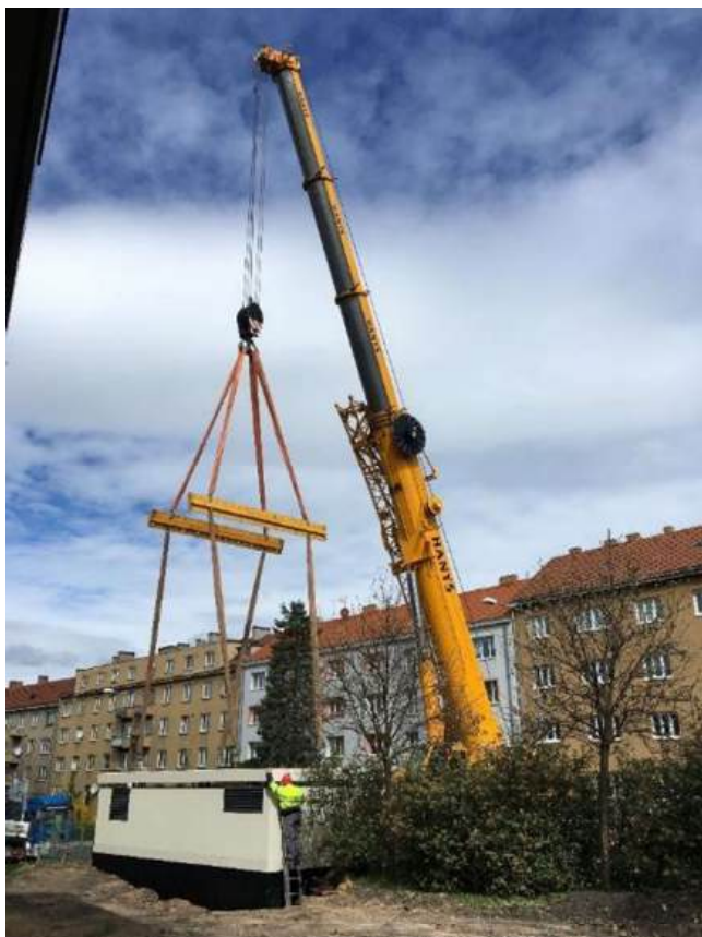
V květnu se stavěla nová trafostanice pro školu
